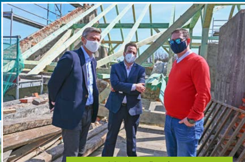
Starosta Richard Vereš s místostarostou Vladimírem Lyčkou na střeše opravované budovy někdejší hrušovské radnice.
